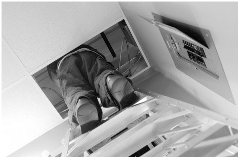
Ciertos daños requieren una inspección cuidadosa, pues no toda rotura anuncia su presencia a través de una filtración en el cielorraso.
