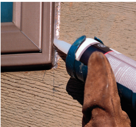
El primer paso para proteger la cubierta es hallar las filtraciones. Las más evidentes se encuentran alrededor de puertas y ventanas.
