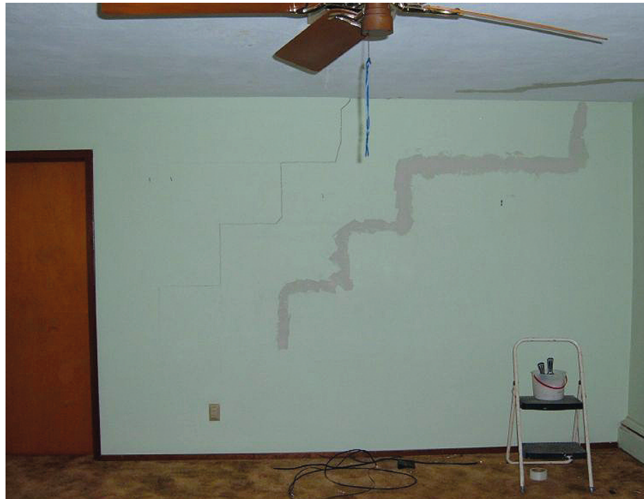
Los cambios de estación forman grietas, si no las sella, puede escapar por allí el calor.
